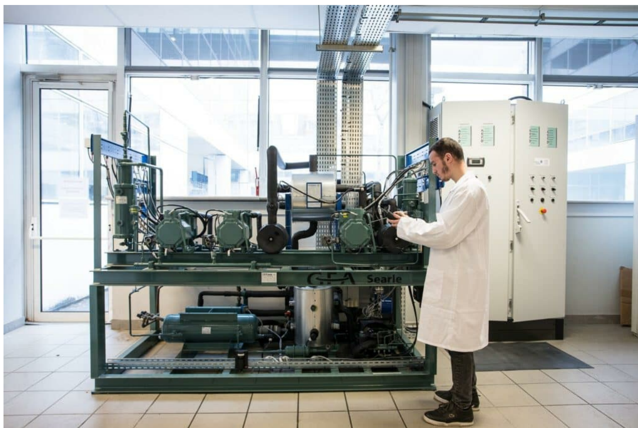
Une centrale frigorifique C02 du lycée Raspail utilisée par un stagiaire du GPI2D.
